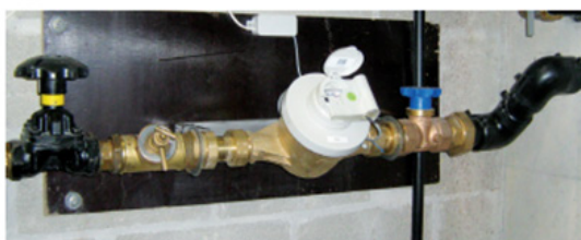
industriële aftakking met leidingdiameter t.e.m. 50 mm
