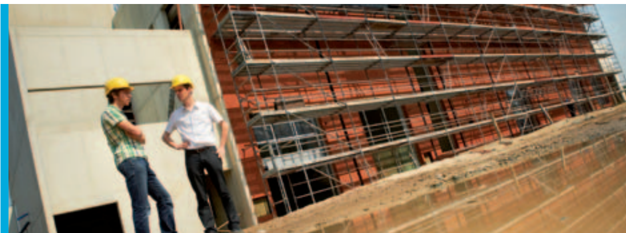
Nieuw waterproductiecentrum met centrale deelontharding in Haasrode
